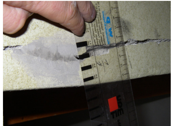
Feststellung der Rissweiten
