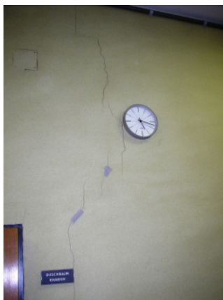
Trennrisse im Kellergeschoß
