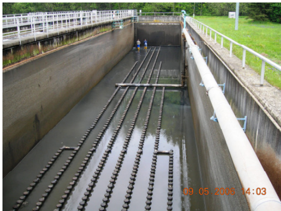
Belebungsbecken I (BB) im entleerten Zustand
