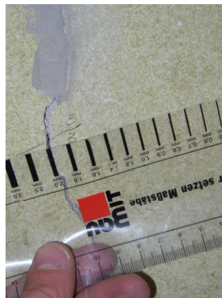
Risse im Erdgeschoss
