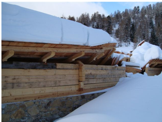
Einsturz zufolge Schneebelastung
