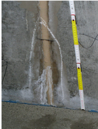
Wassereintritte in den Baufugen der Kellerwand
