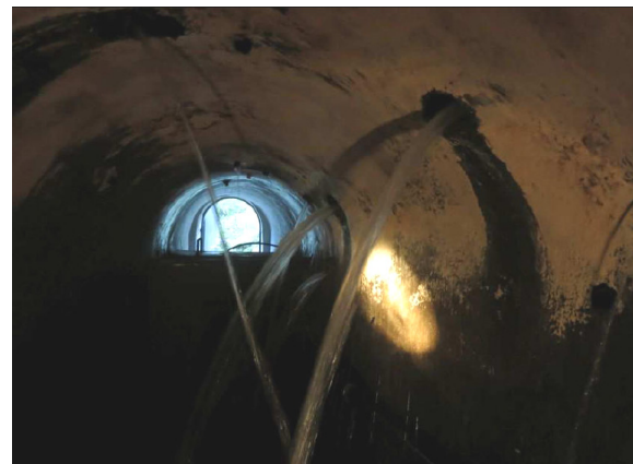
Quellwasserzutritt zu den Speicherstollen
