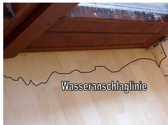
Kondensatbildung vor der Balkontür
